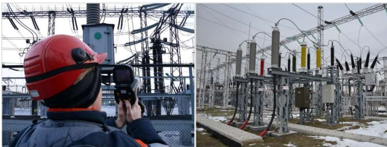
Рисунок 1 – Тепловизионный контроль состояния электрооборудования
